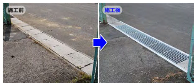
岐阜県 [工期] 半日/全長4m 乗り入れ部の破損対策
